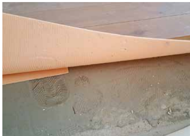
Levná pokládky dřevěné podlahoviny, která investora stála nemalé peníze. Kdo chce levně, musí si připlácat.
